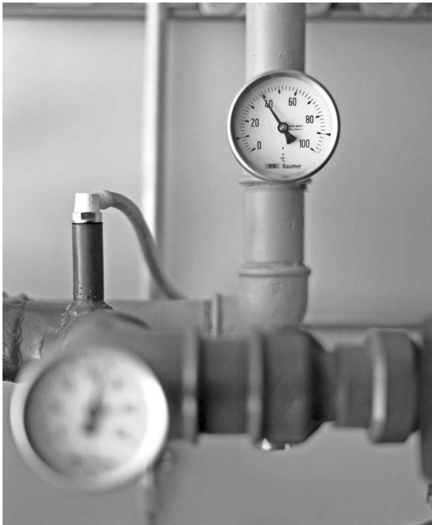
En matière de chauffage, les locataires ne sont pas responsables des installations utilisées. KEYSTONE-ARCHIVES
